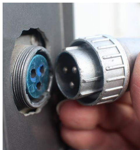
●外部電源引き込み口(100V)
