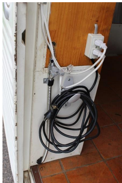
●外部電源引き込み場所
