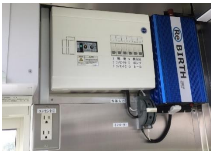
●外部電気引込みブレーカー (15A) 車内コンセント
