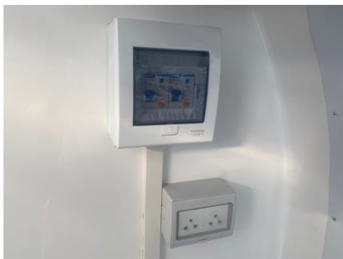
●車内コンセント、ブレーカー
